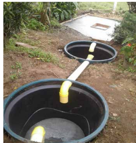
*Instalación de las canecas y tubería para las canecas y pozo de absorción.
