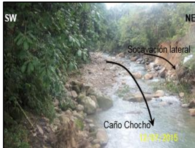
Fotografía 4.2-15 Socavación lateral y de fondo margen izquierda del caño Chocho Fuente: Antea group, 2015
