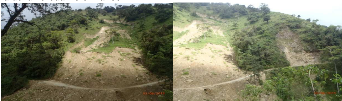
Foto 4 Carretera Pradera – vereda Bolo Azul, con derrumbes especialmente en la zona de la vereda Bolo Blanco
