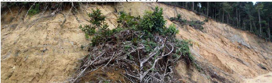
Foto 3 Deslizamiento en suelo residual (GPS 087)
