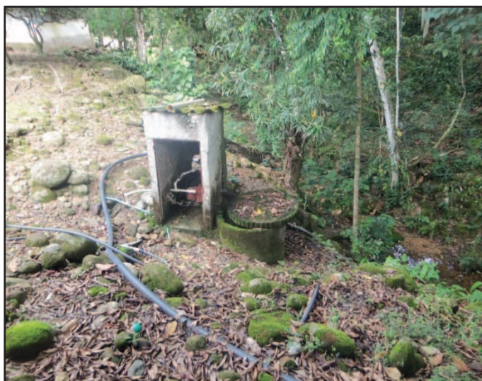
Fotografía 3.2-92 Captación de agua mediante motobomba Fuente: CONSORCIO INGEDISA DESSAU ANTEA SAN FERNANDO, 2017
