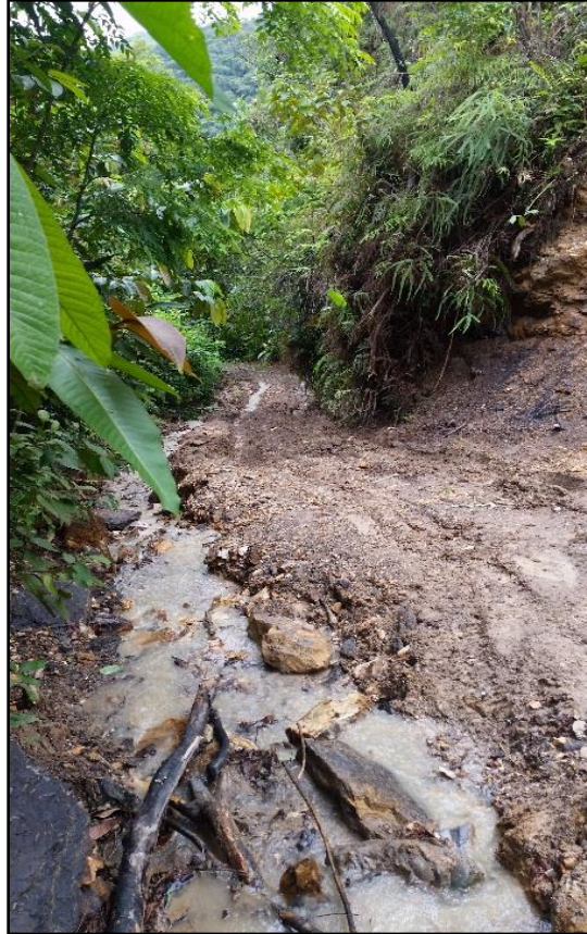
Fotografía 5-4 Erosión acentuada en un tramo de una vía de tercer nivel en la zona montañosa (; Coordenadas Magna Sirgas Origen Bogotá E= 1038534,00 N= 943559,00.
