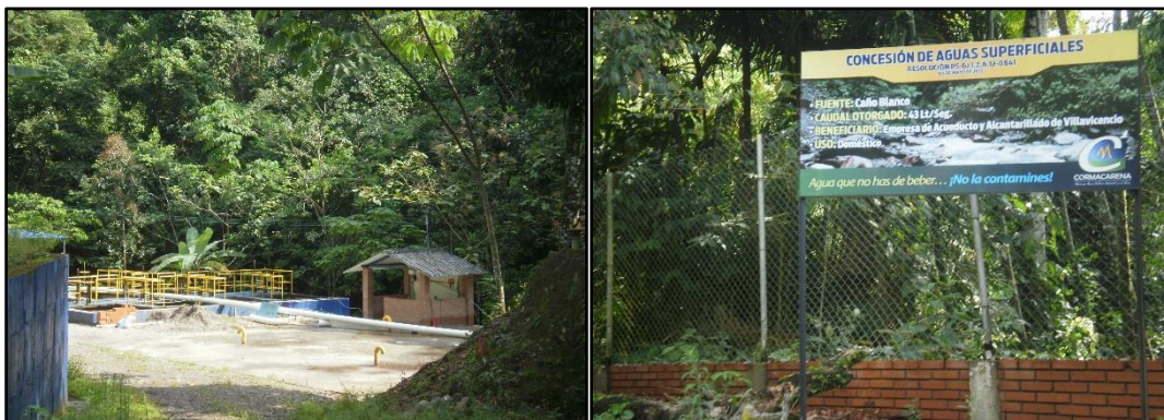
Fotografía 5-24 Planta de tratamiento de agua potable Caño Blanco E: 1036526,15 N: 940366,717
