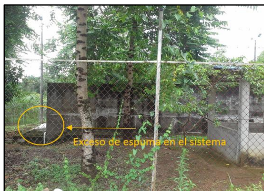
Fotografía 5-32 Tratamiento de aguas residuales –vereda San isidro de Chichimene, Coordenadas origen magna Colombia Bogotá, Este: 1043725,27179 Norte: 924353,634304 tomada en dirección suroeste.
