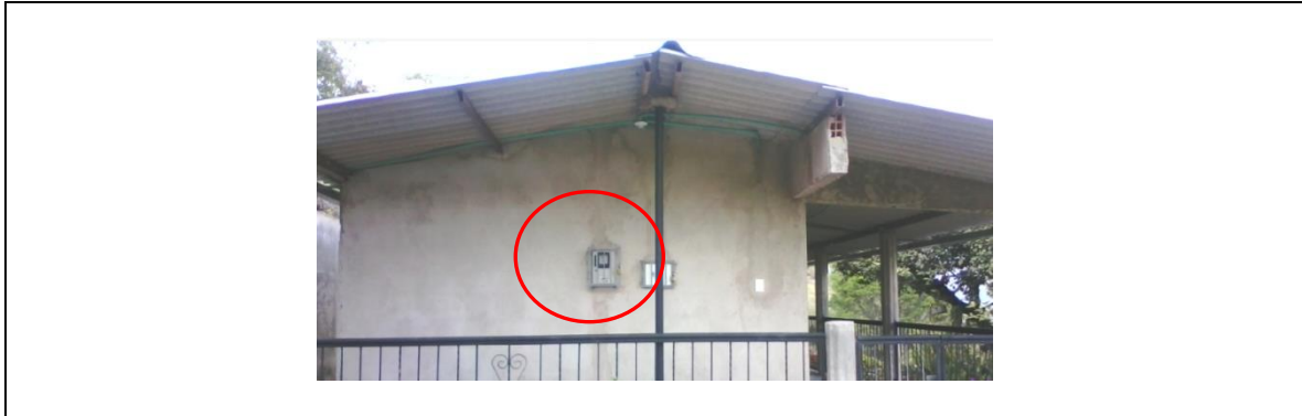
Fotografía 3-17 Contador de energía eléctrica predio vereda Mutatea
