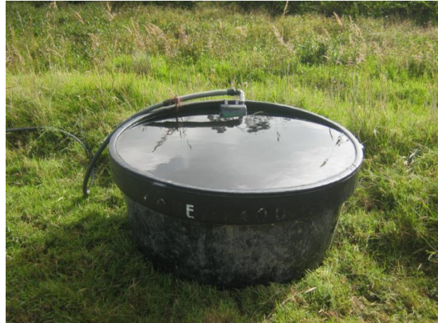
Fotografía 3-36 Tanque de almacenamiento predio vereda Boitá
