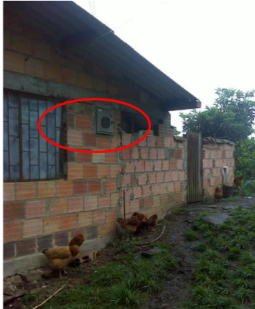
Fotografía 3-22 Contador de energía eléctrica predio vereda Renquira
