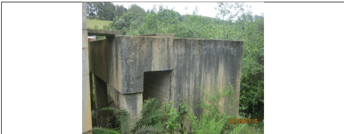
Fotografía 3-29 Tanque de almacenamiento predio vereda Boquerón Fuente: Consorcio Ambiental Chivor 2016.
