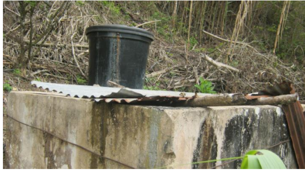
Fotografía 3-15 Tanque de almacenamiento predio vereda Mutatea
