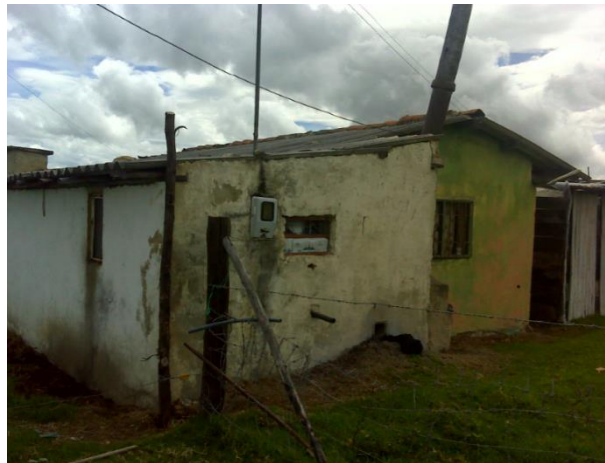
Fotografía 3-33 Contador de energía eléctrica predio vereda Santa Rosa
