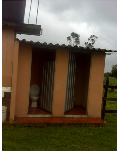
Fotografía 3-43 Inodoro conectado a pozo séptico predio vereda Rodamontal
