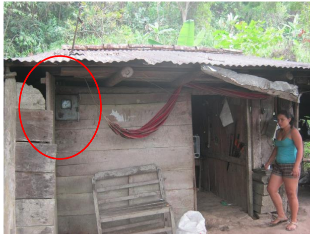
Fotografía 3-4 Contador servicio de energía predio vereda San Agustín
