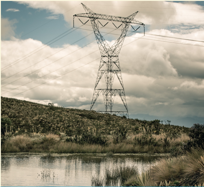
Laguna de Guambita Guasca - Activo en operación
