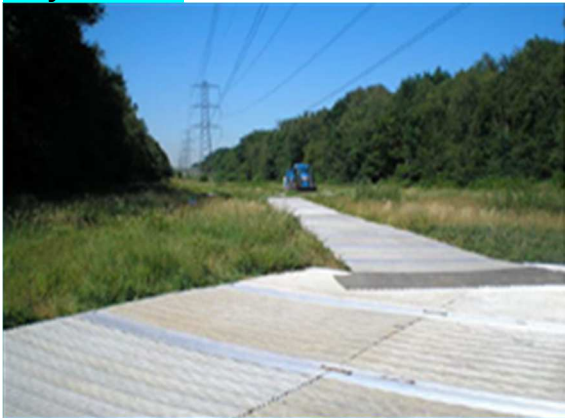
Fotografía 2-197 Colocación de paneles portátiles para formar superficie de acceso temporal en zonas con suelos muy blandos
