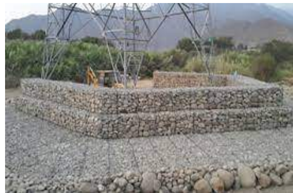
Fotografía 6. Gaviones para control de erosión y estabilidad Fuente: GEB. (2022).
