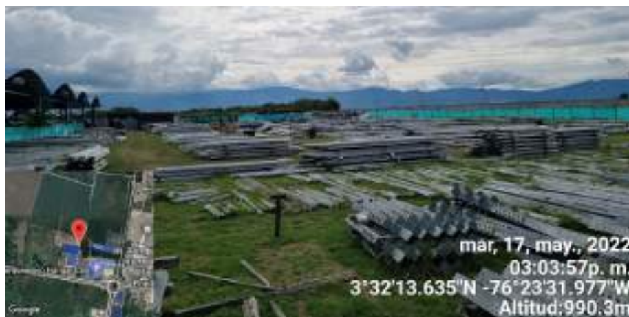
Fotografía 114. Disposición de la estructura y las bobinas al interior de un patio de almacenamiento
