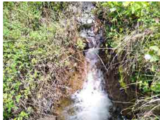
Fotografía 35. Drenaje de agua Q. La
