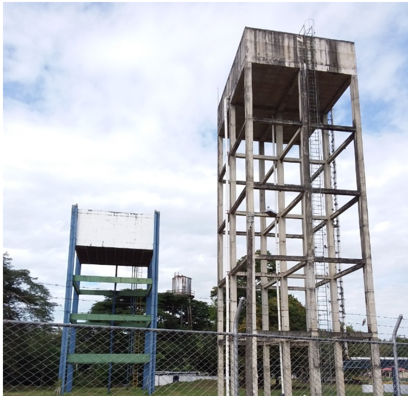
Fotografía 168. Acueducto corregimiento La Paila
