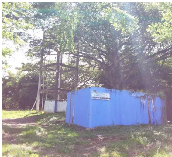
Fotografía 156. Acueducto corregimiento Vallejuelo
