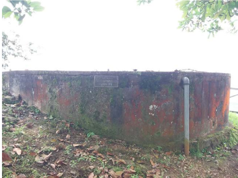
Fotografía 189. Acueducto centro poblado corregimiento Pardo
