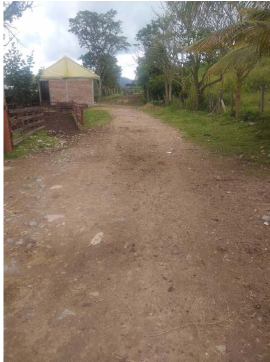
Fotografía 236. Vía Tuluá - Naranjal
