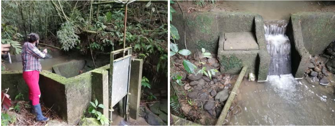
Fotografía 53. Acueducto centro poblado corregimiento Modín
