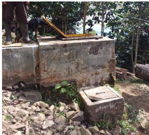
Fotografía 304. Acueducto veredal Barranco Alto
