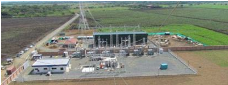
Fotografía 510. Vista Subestación Alférez II CELSIA y GEB Fuente: CELSIA 2014
