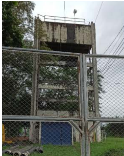
Fotografía 361. Tanque de almacenamiento
