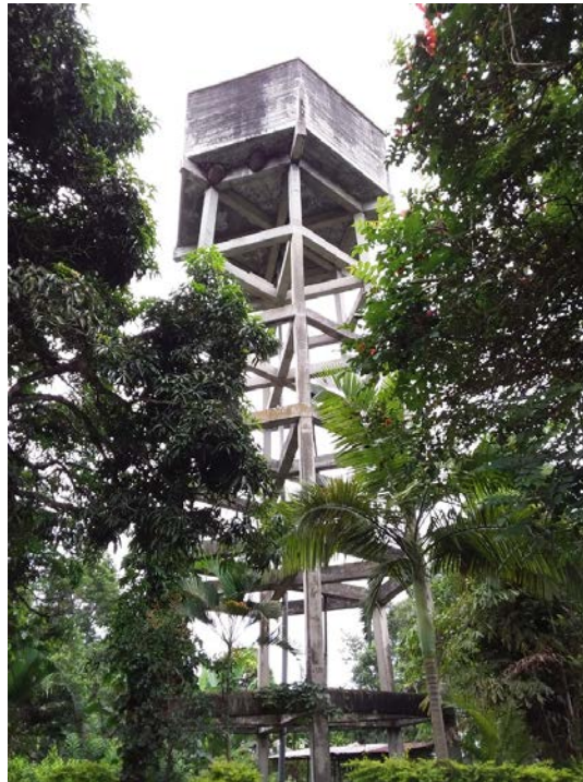
Fotografía 380. Acueducto corregimiento Buchitolo
