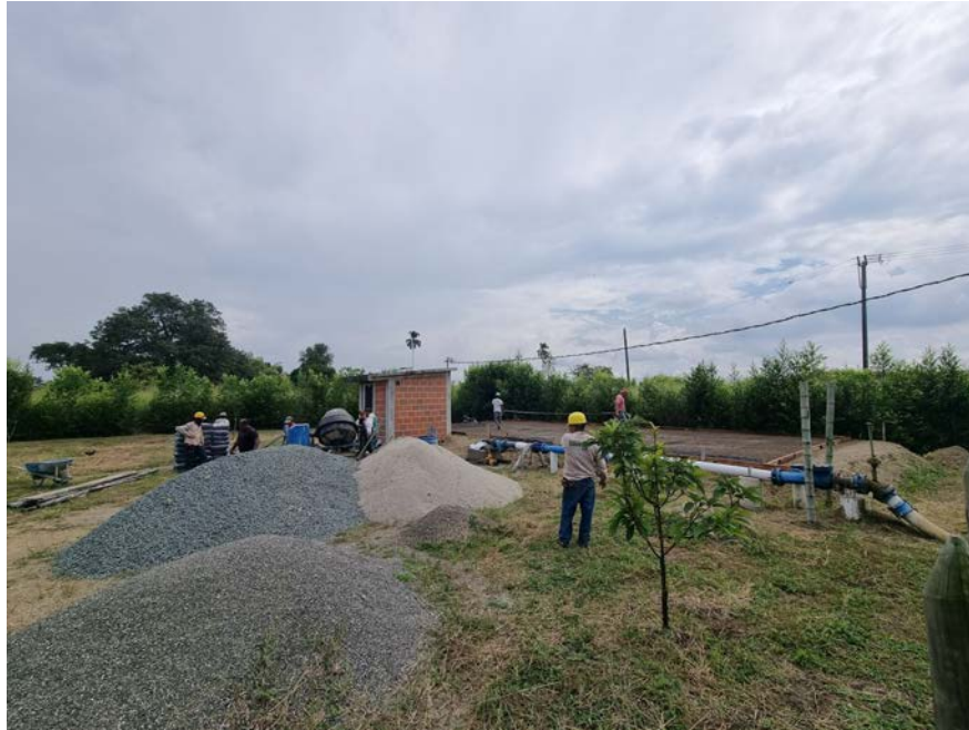
Fotografía 398. Acueducto corregimiento El Cabuyal
